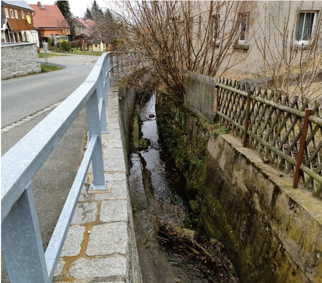
Abbildung 6.7: Markante Engstelle des Geringes bei km 4+910 stromauf der Brücke Nr. 40 Dorfstraße
