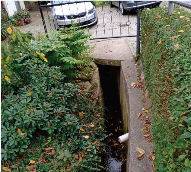
Abbildung 6.2: Markante Engstelle am Auslauf der Brücke Nr. 48 bei km 5+490
