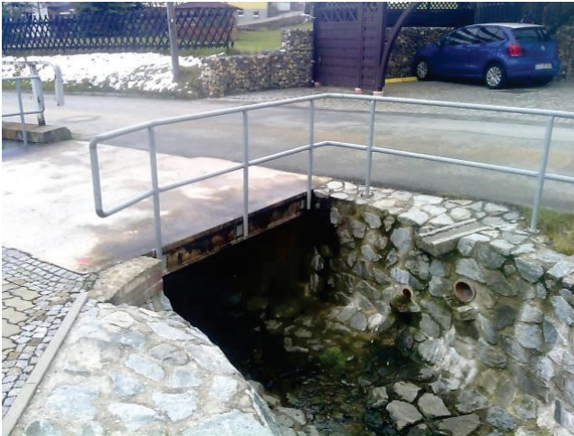
Abbildung 6.4: Gewässerknick am Einlauf der Brücke Nr. 37 bei km 4+734
